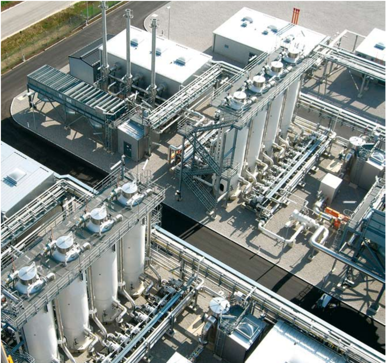
Erdgasaufbereitung, Reduzierung des Wasser- und Kohlenwasserstoff-Taupunktes Durchsatz: 260.000 Nm 3 /h, Betriebsdruck: 45...90 bar Natural gas treatment, water- and hydrocarbon dew pointing Flow rate: 260,000 Nm 3 /h, Operation pressure: 45...90 bar
