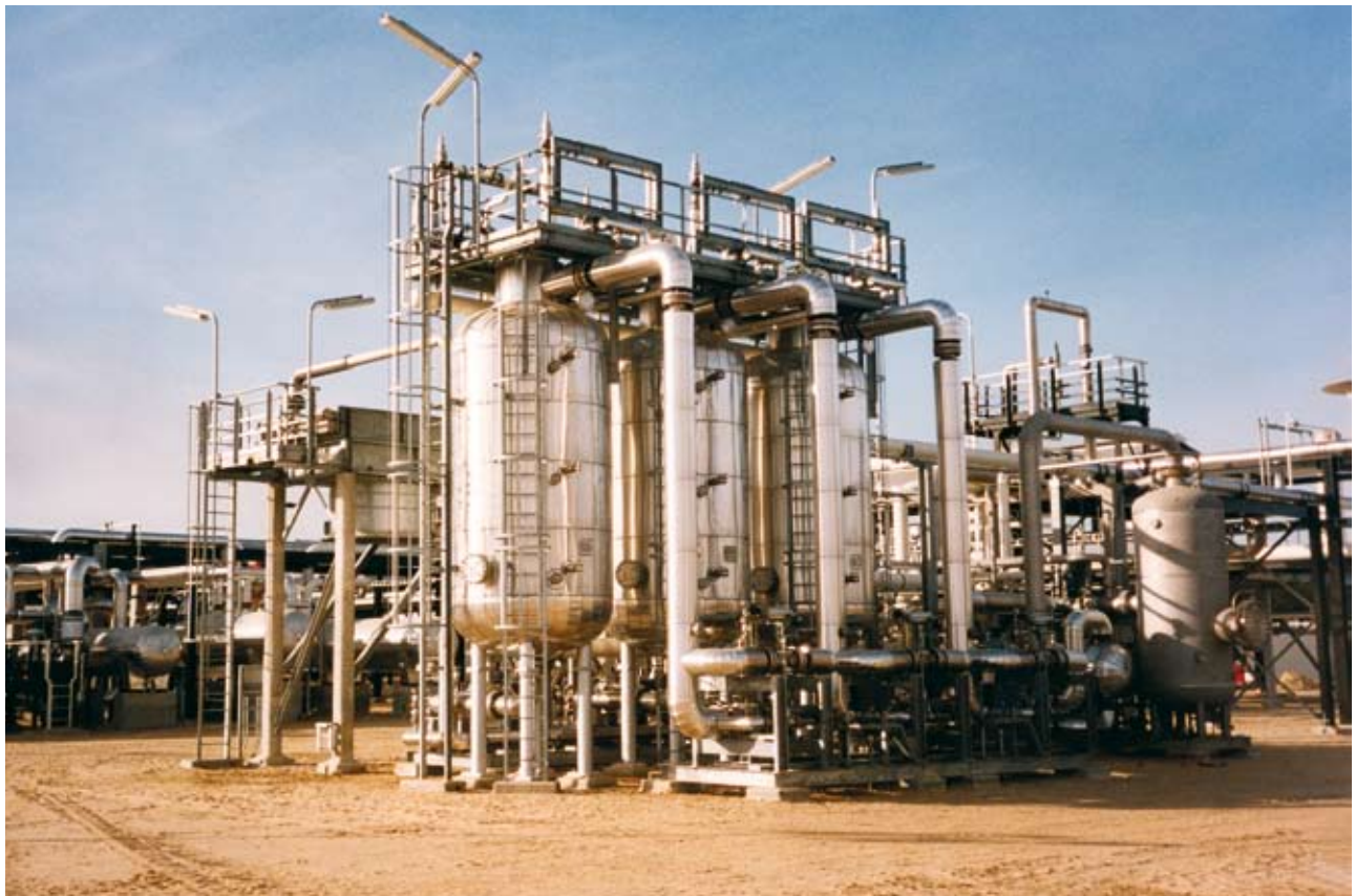
Erdöl-Begleitgas-Trocknung, Regeneration unter Druck Durchsatz: 110.000 Nm 3 /h, Betriebsdruck: 31 bar Drying unit for petroleum gas, regeneration under pressure Flow rate: 110,000 Nm 3 /h, Operation pressure: 31 bar
