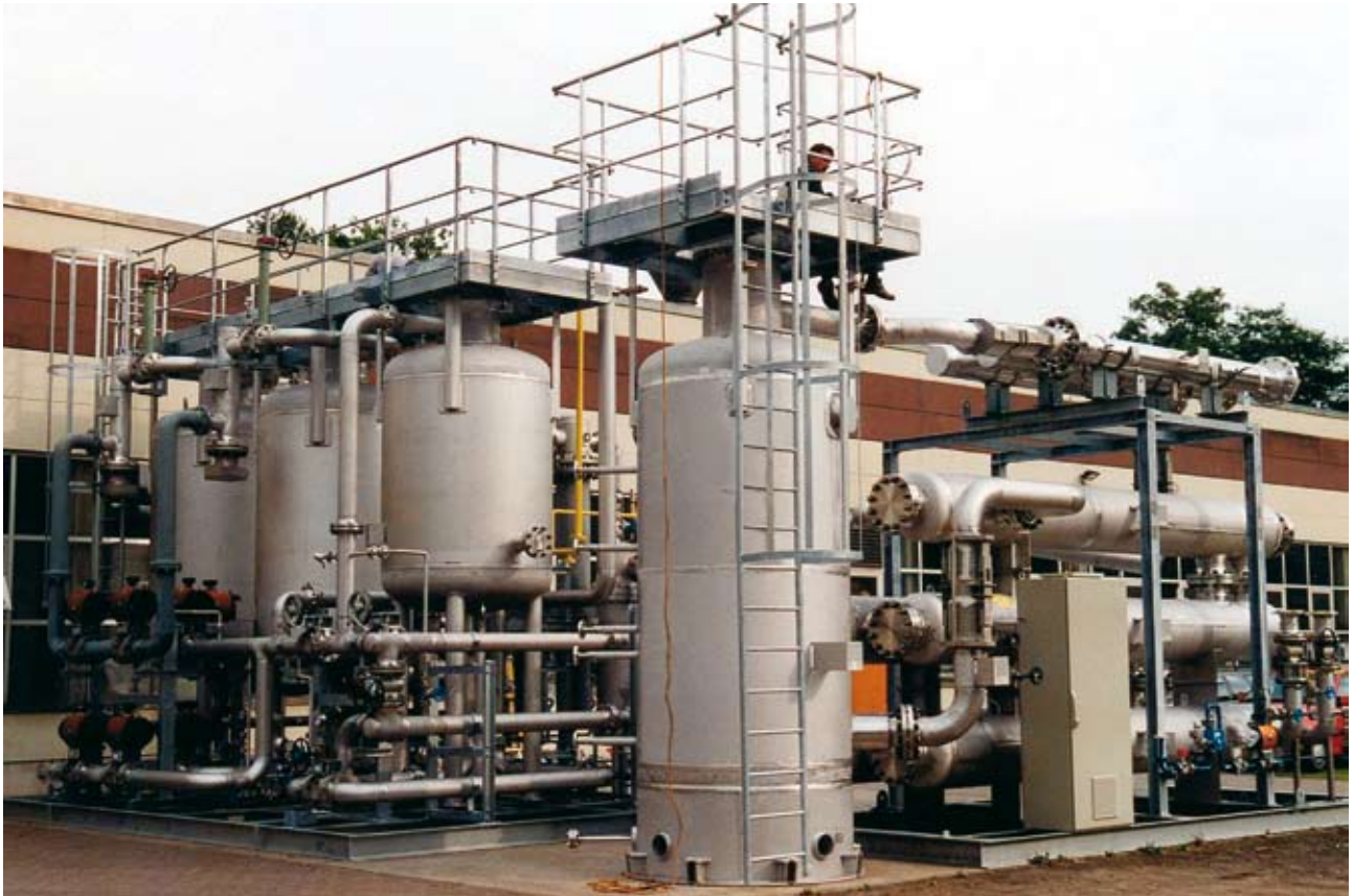
Kohlendioxid Reinigungs- und Trocknungsanlage Durchsatz: 22.000 kg/h, Betriebsdruck: 19 bar Carbondioxide purification and drying unit Flow rate: 22,000 kg/h, Operation pressure: 19 bar
